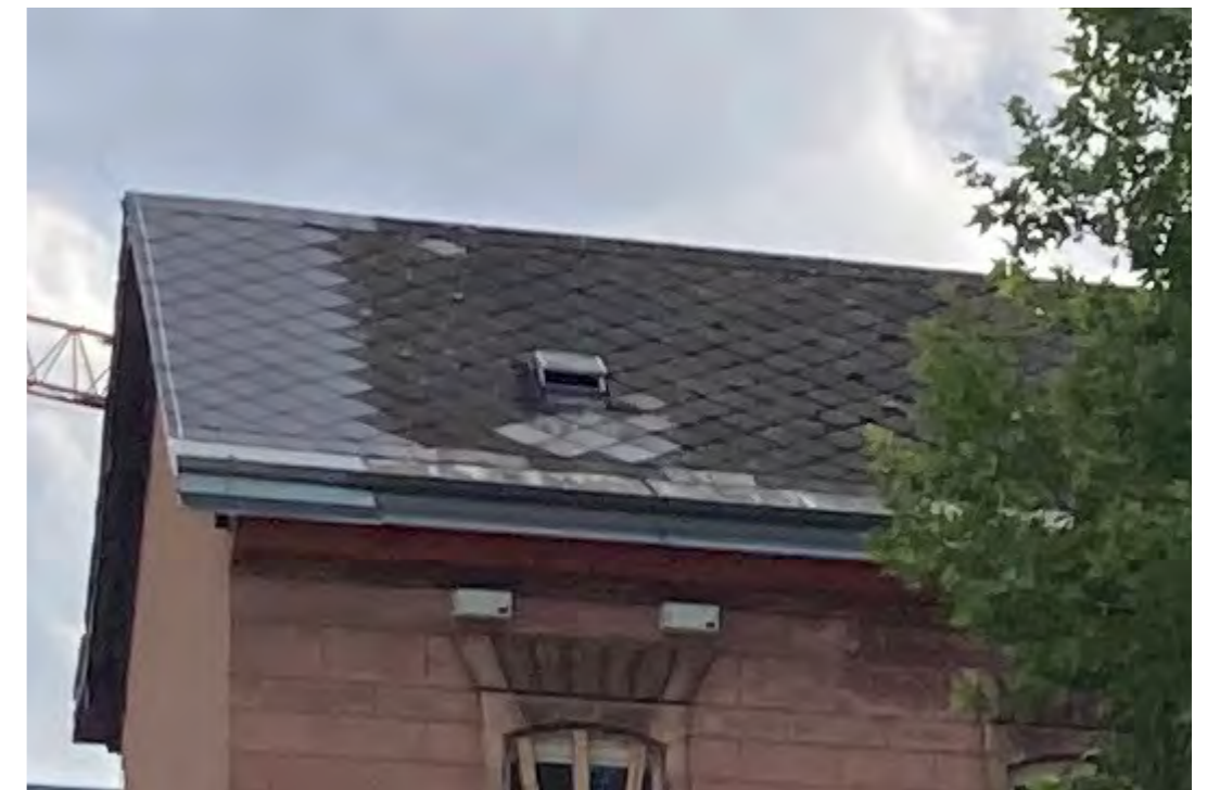
Unten: Auf der Nordseite ist im Anschlussbereich zu den neuen Fassaden im Osten und Westen deutlich der Unterschied zwischen neuer zu älterer Schieferdeckung zu erkennen. Die ältere Schieferdeckung ist deutlich angewittert und rauer. In Teilen sind auch Moose und Flechten zu erkennen.
