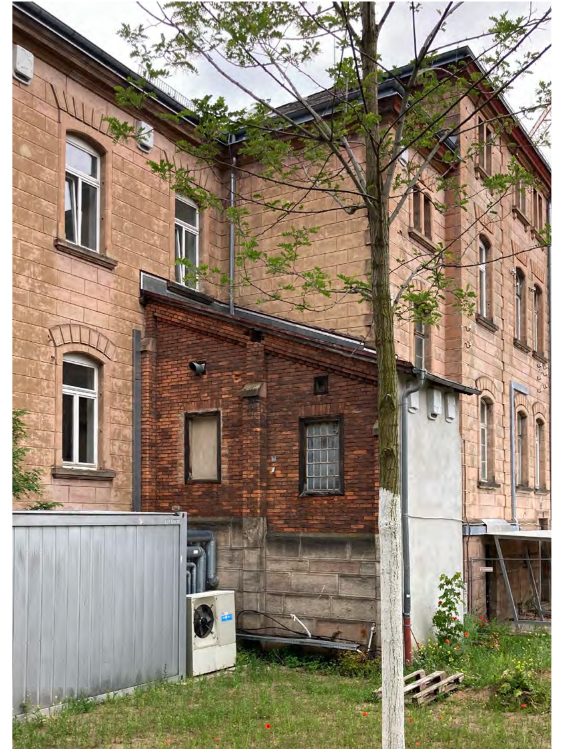
Das Foto zeigt die Süd-West-Ecke des Mittelrisalit mit dem westlichen Treppenhaus und der davor befindlichen Anschlussstelle bzw. dem Rest des ehemaligen Verbindungsganges zu den südlichen Flügeln der Heil- und Pflegeanstalt. Die Schnittstelle bzw. Abbruchstelle wurde ähnlich wie die West- Ostfassaden der Schwabachanlage 10 vermauert und verputzt.
