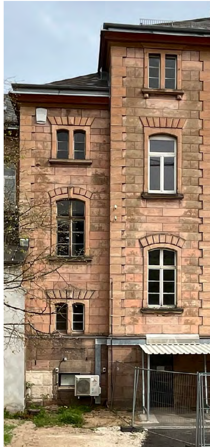
Fassadenausschnitt der südwestlichen Ecke des Mittelbaus und des westlichen Treppenhauses. Die Fenster im Treppenhaus sind bauzeitlich, während im Mittelbau und den Flügeln auch neuzeitliche Holzfenster verbaut wurden.
