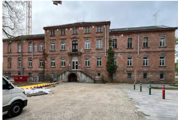
Oben: Blick auf die Nord-West-Ecke der Schwabachanlage. Die westliche Fassade wurde im Zuge des Teilabbruchs des westlichen Flügels 2020 als glatt geputzte Wand in Art einer Brandwand ausgeführt. Unten: Nordseite der Schwabachanlage 10. Die Fassade ist von der strengen Spiegelsymmetrie bestimmt. Das äußere Erscheinungsbild entspricht in weiten Teilen dem historischen Ursprungszustand.
